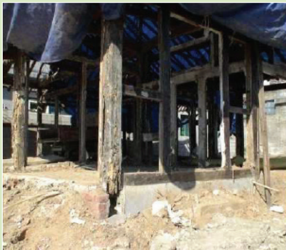
石がなくなって基礎腐食
